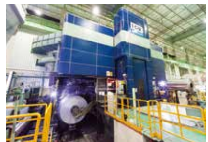
6段冷間圧延機
